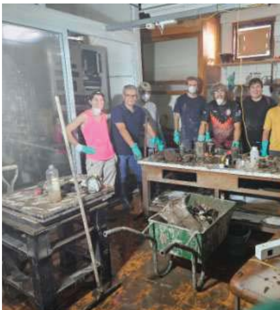
Figura 5: Personal de la UNS trabajando en la recuperación de uno de los laboratorios afectados.
